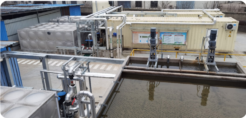
华润化学材料污水站提标及中水回用项目设备
