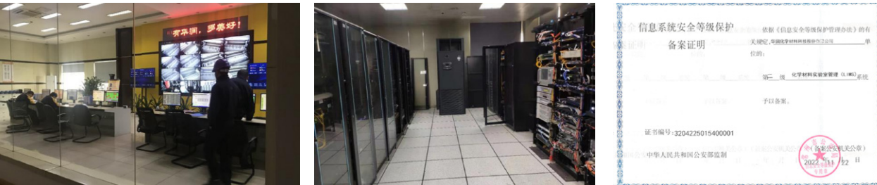
网闸系统及机房全方位保障生产数据安全
