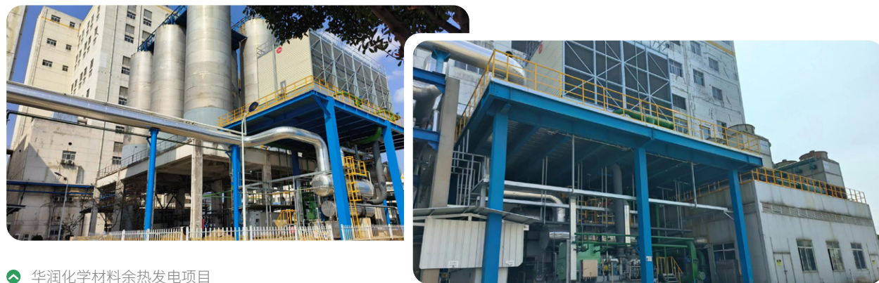
华润化学材料余热发电项目
